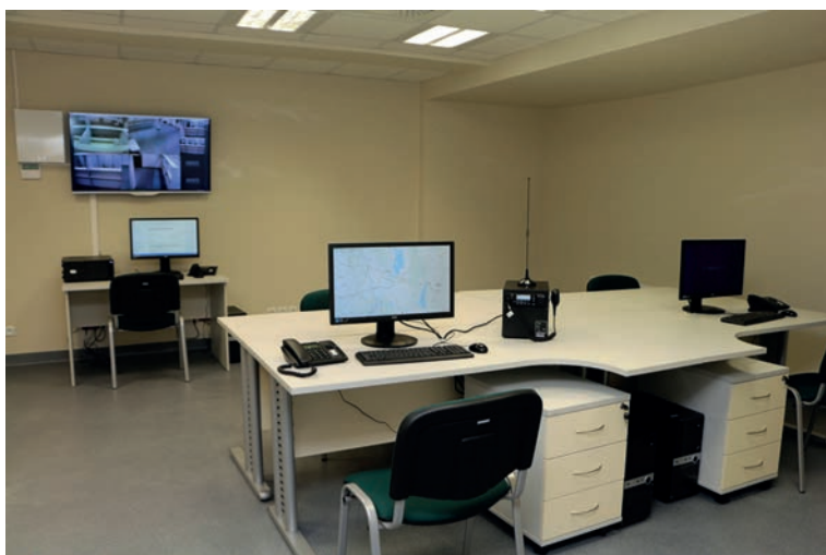
Fot. 4.15. Stanowiska pracy systemu monitoringu
