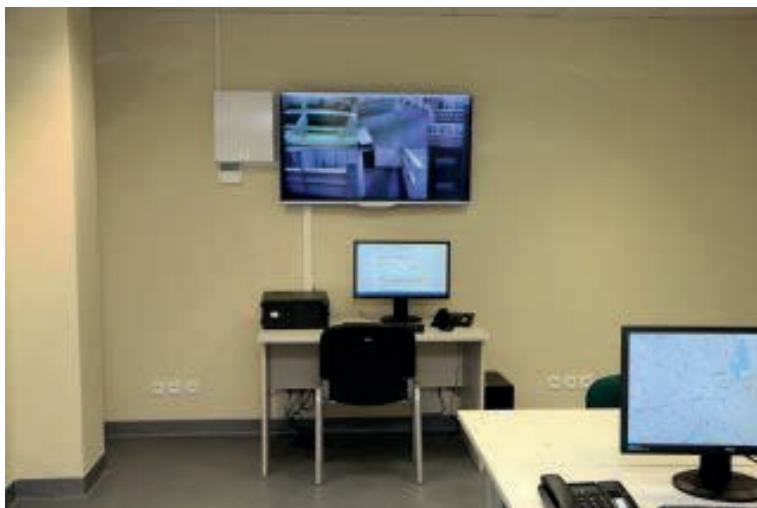
Fot. 4.18. Stanowiska pracy systemu monitoringu
